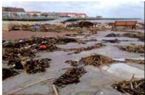
Photographies du perré de Petit-Fort-Philippe pendant et après la tempête Xaver (source : dossier d'enquête)
