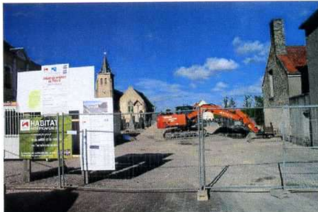
Le chantier de la future maison médicale vient de débuter. Il est compris dans le projet, plus global, de réaménagement de la Grand'Place.
